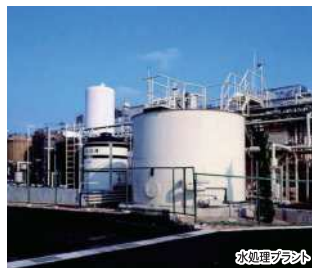
水処理プラント
